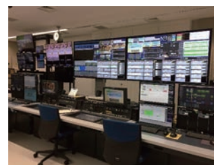
地域局番組送出設備
