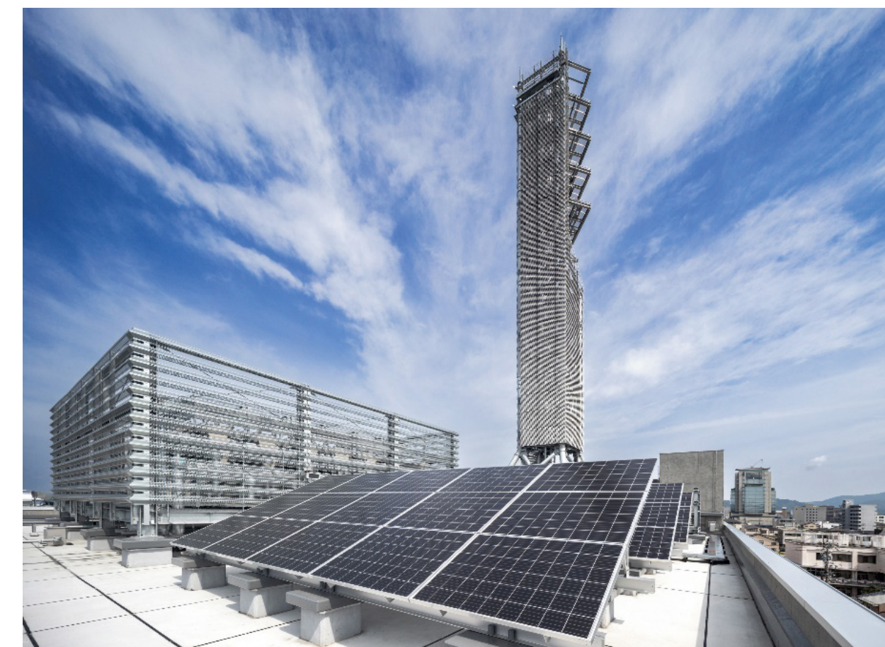
太陽光発電設備
