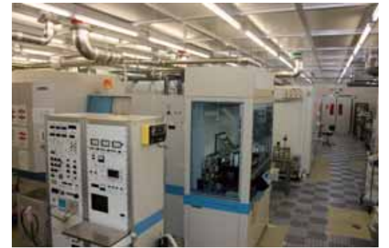
クリーンルーム
