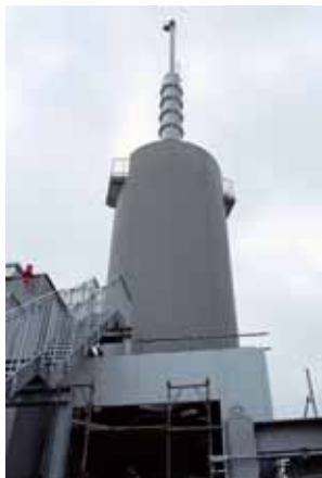
アンテナ鉄塔
