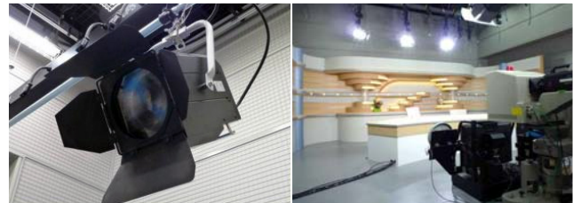
LEDスタジオ照明器具 千葉新会館ニューススタジオ
