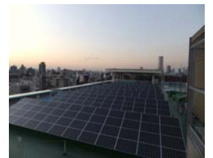
放送センター 太陽光発電パネル
